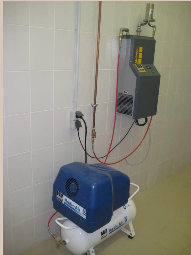
Воздушный компрессор, осушитель воздуха air compressor, air dryer
