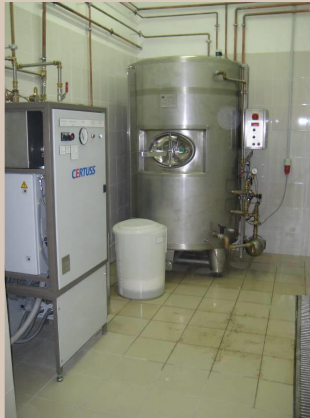
парогенератор, грязевик, танк для горячей воды steam generator, pressure steam separator vessel, hot water tank
