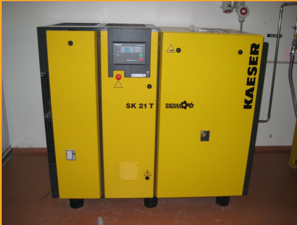
Техническое помещение (компрессор)
