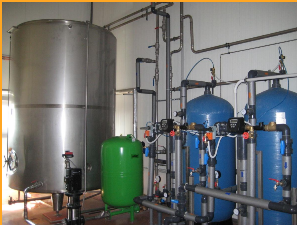
Техническое помещение (накопитель воды)
