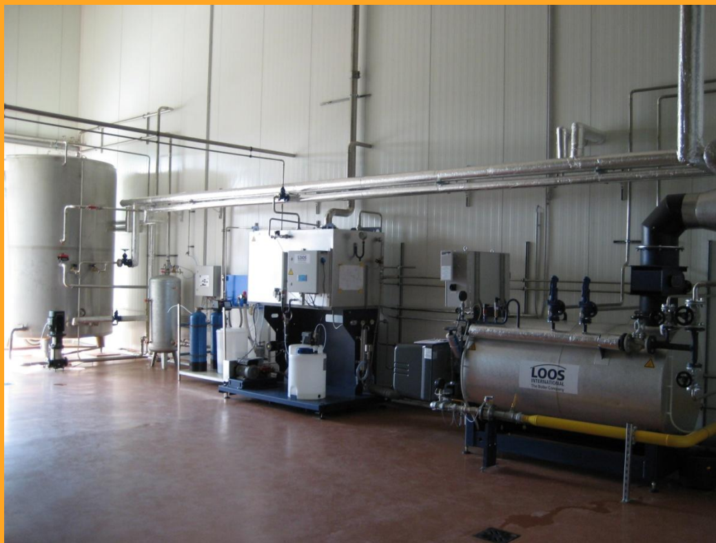
Техническое помещение (накопитель воды, парогенератор)
